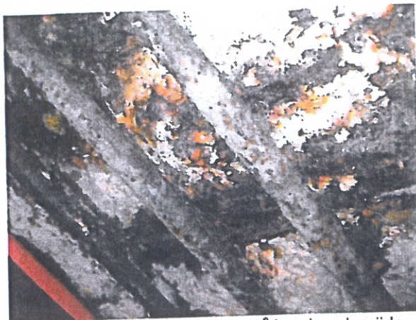
Figuur 3.3: Verdeelwapening (2 e laag) onderzijde betonelementen zwaar gecorrodeerd
